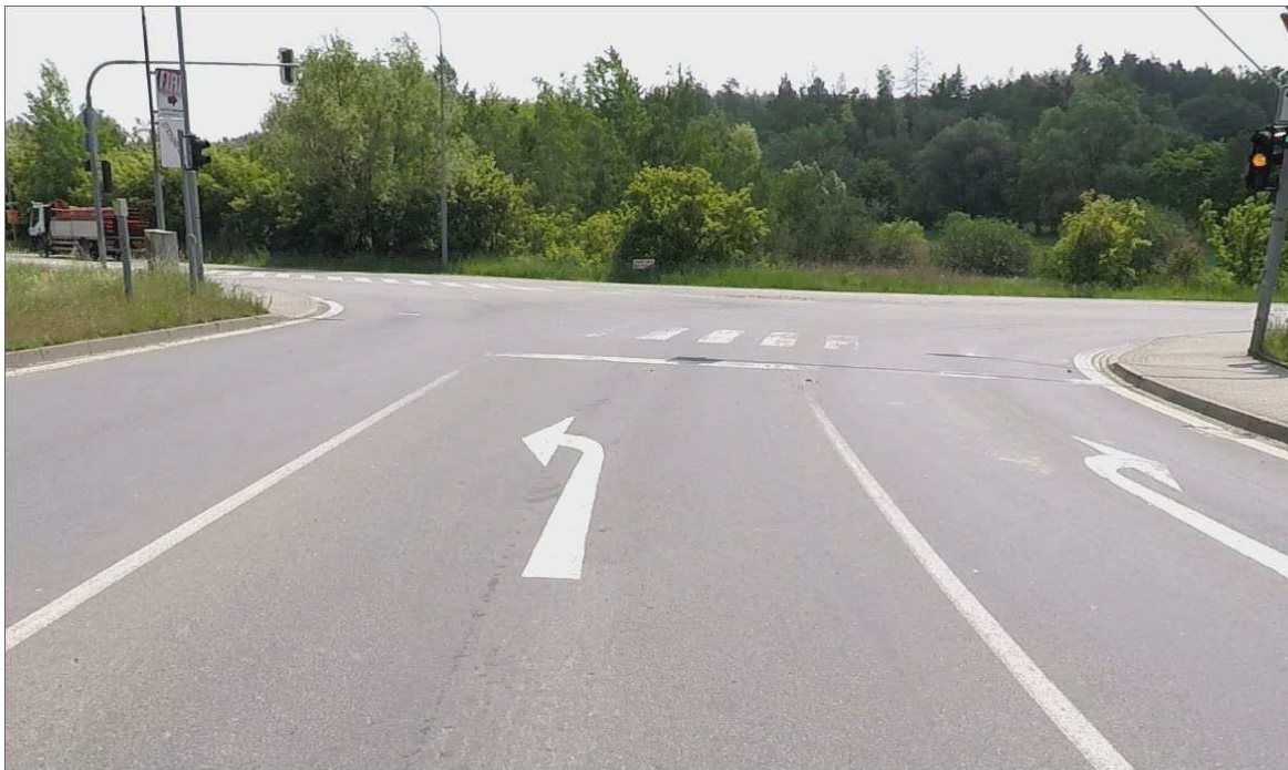
Obrázek 8.5: Opotřebované VDZ u přechodu pro chodce v ulici Brněnská.
